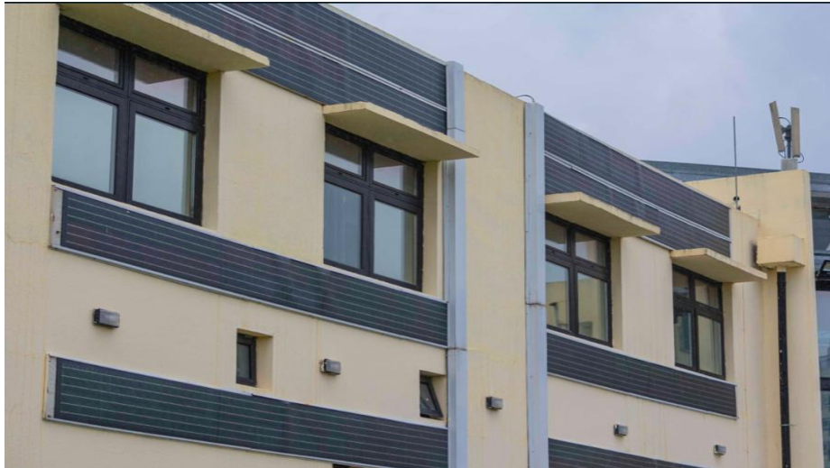
Vista de paneles solares para la generación de energía eléctrica en paredes del edificio central de CIFA.
